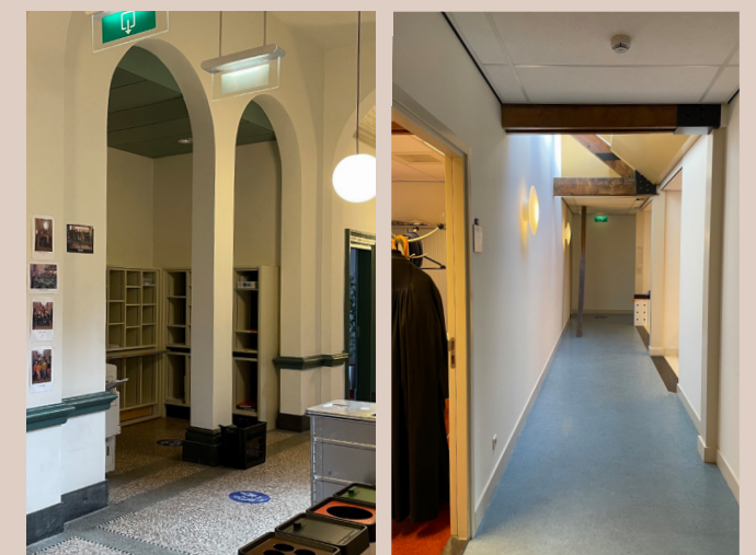
Het gebouw voor transformatie met verlaagde plafonds en vele kantoor-tjes
