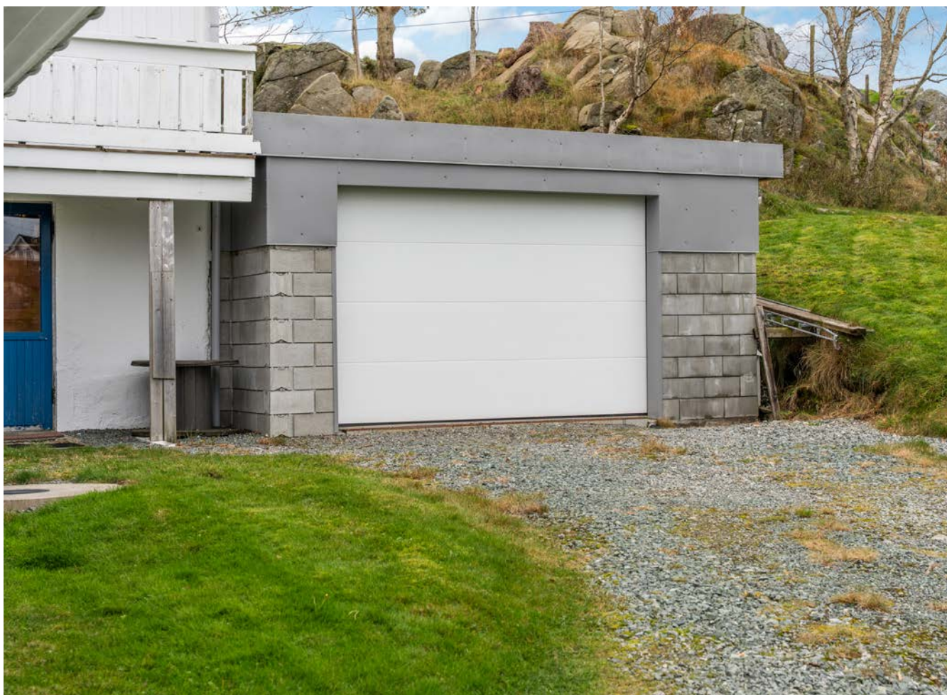
Garasjen er bygd i nyere tid, dog ikke godkjent/byggemeldt.
