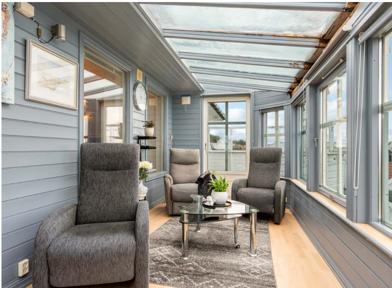
Sommerstue i leilighet i 2. etasje i Sjoarvegen4 A, glasstak må byttes
