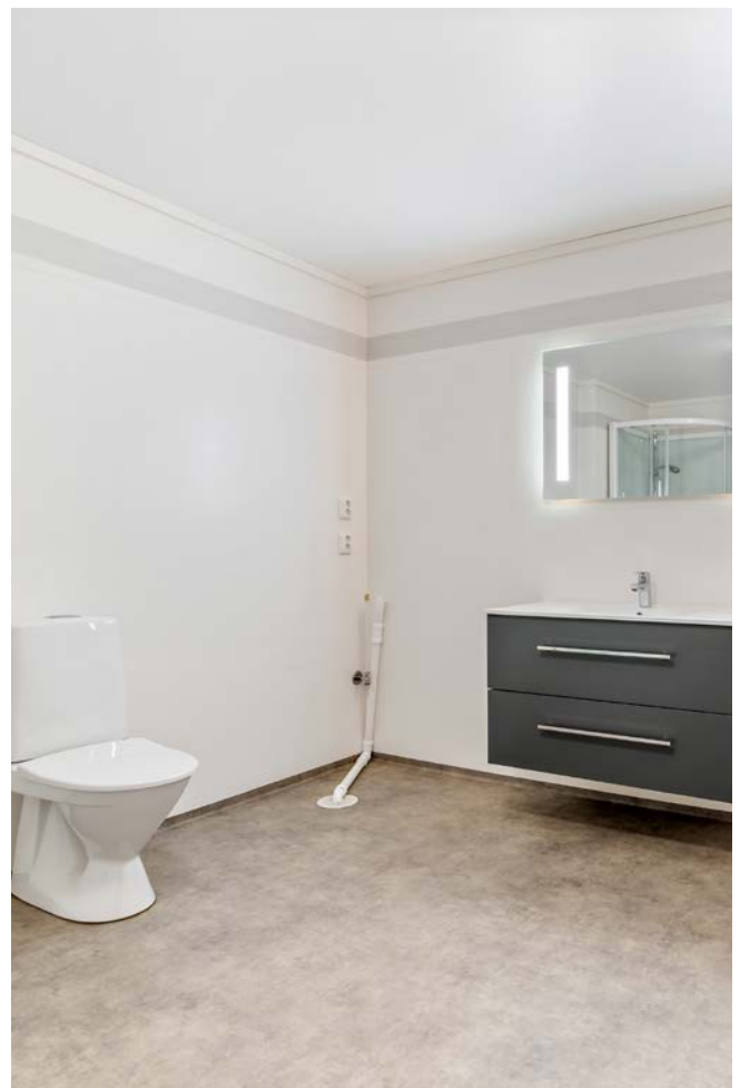
Opplegg for vaskemaskin/tørketrommel, samt varmekabler i
