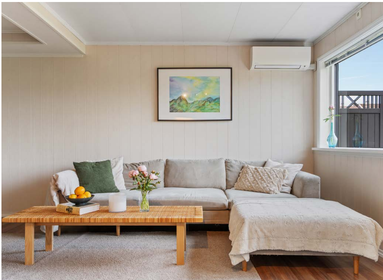
Det er monteret varmepumpe i stue
