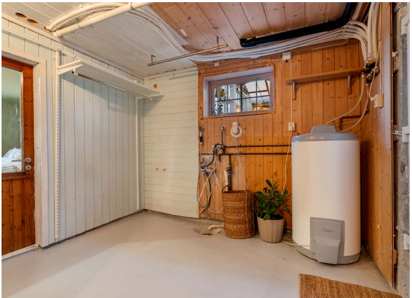
Mesteparten av røropplegg er oppgradert.
