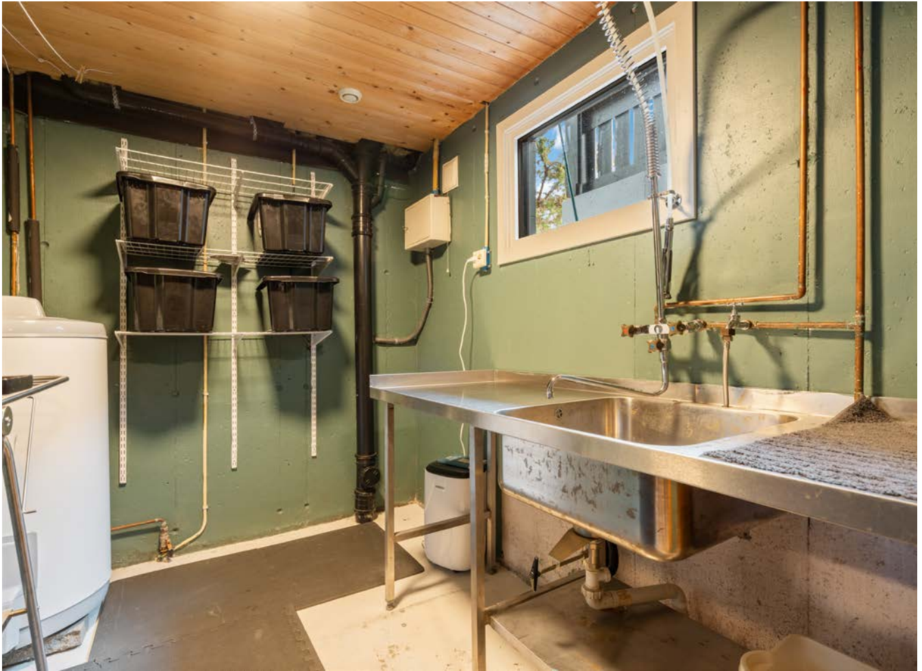
Vaskerom i uinnredet enkel standard. Fungerer fint til sitt bruk.
