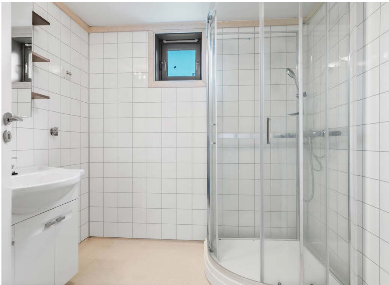
Varmekabler og opplegg for vaskemaskin på bad
