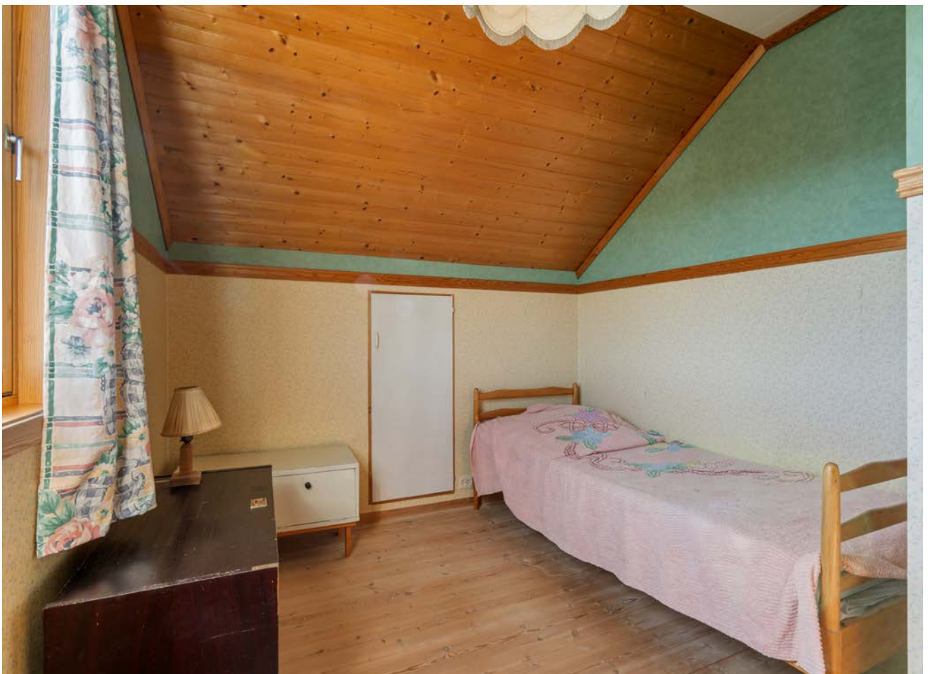
Soverom 2 i loftsetasjen. Tilkomst til knevegg og luke i tak til ytterligere oppbevaring og villavent systemet.
