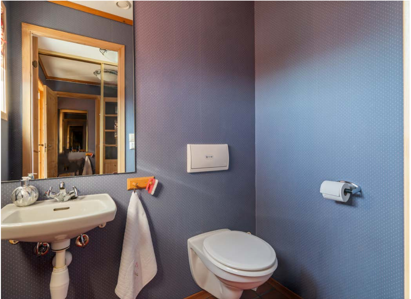
Gjestetoilet i forbindelse med vindfang første etasje. Varmekabler i gulv.
