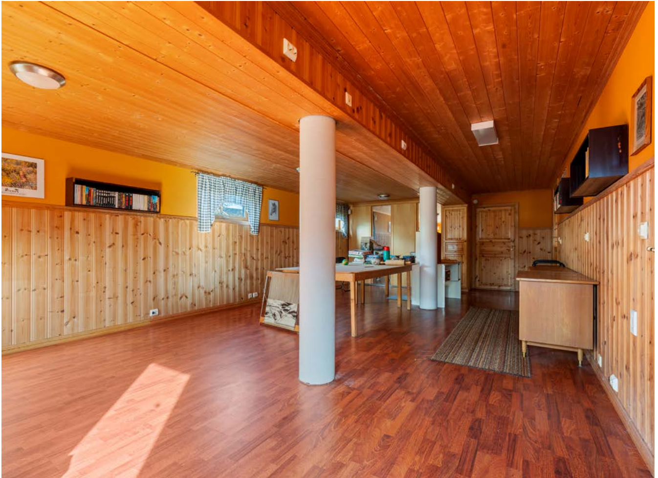
Svært romslig rom med varmekabler i gulv (flere soner).
