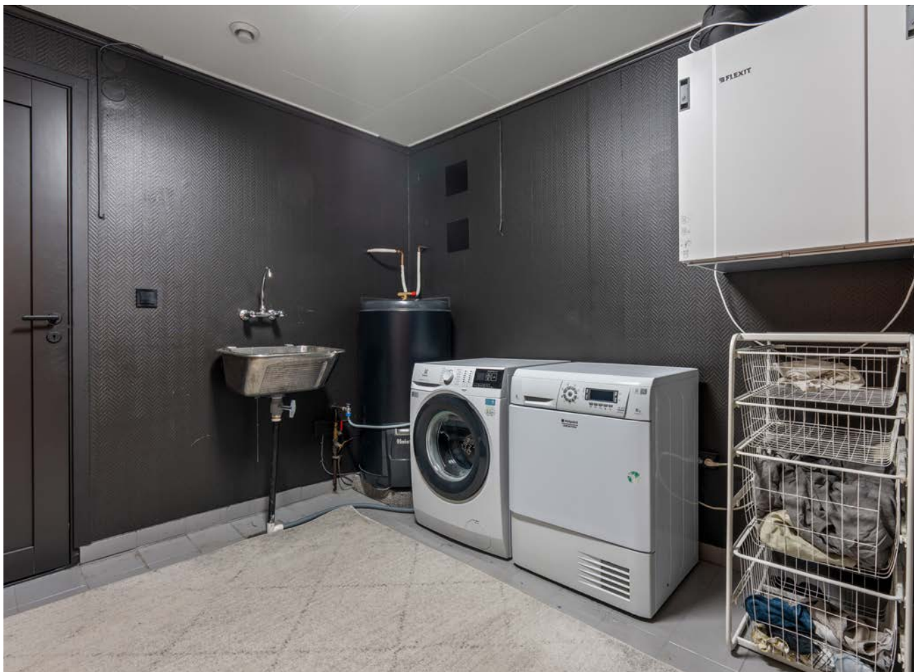
Romslig vaskerom i underetasje. Nyere "smart" varmtvannsbereider og nylig installert balansert ventilasjonsanlegg.
